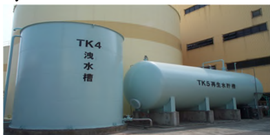
圖 1、鍋爐洩水儲存槽
